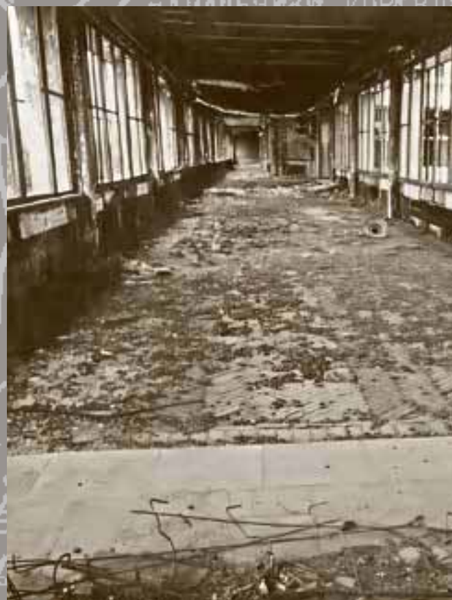
▲ Разрушенная верхняя галерея драматического театра им. М. Горького. РОМК
